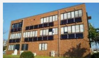
宮崎大学 ZEB実証実験施設
